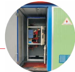
变电站高压室
