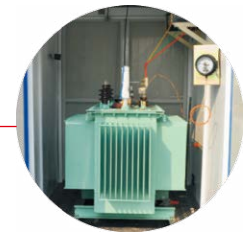
变电站高压器室
